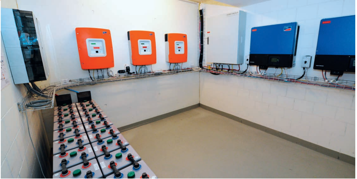
Batteries, redresseurs et onduleurs.
